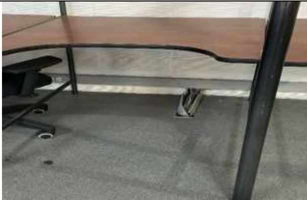
Foto 3. Corresponde al peligro de corto circuito por cables expuestos
