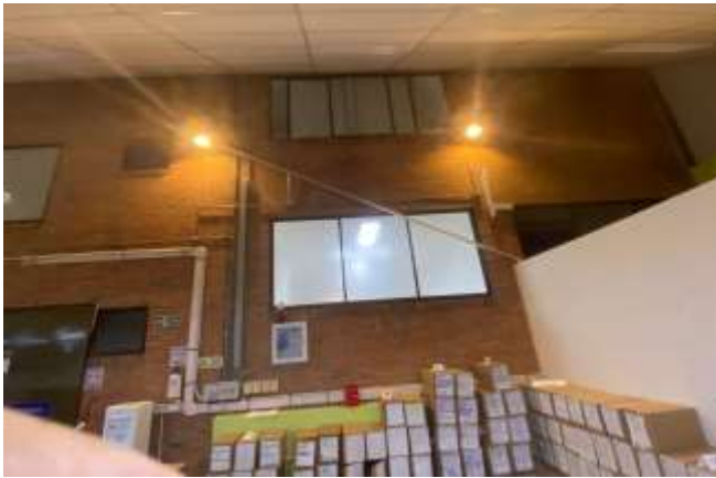
Foto 7. Riesgo de accidente por objeto (Viga) mal ubicado
