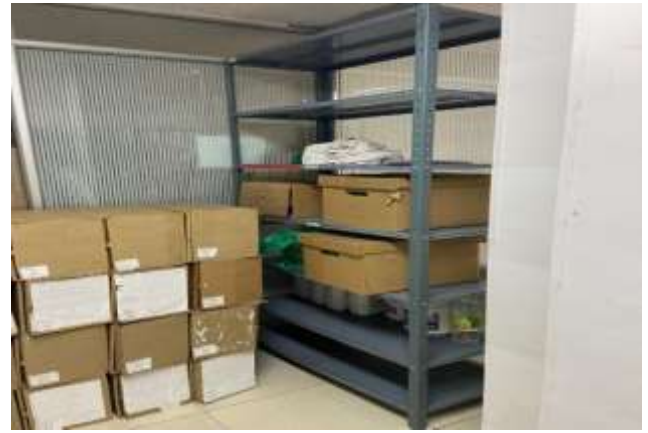
Foto 8. Deterioro de objetos a causa de humedad
